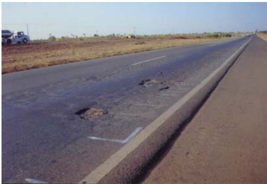
一般的な舗装における損傷
