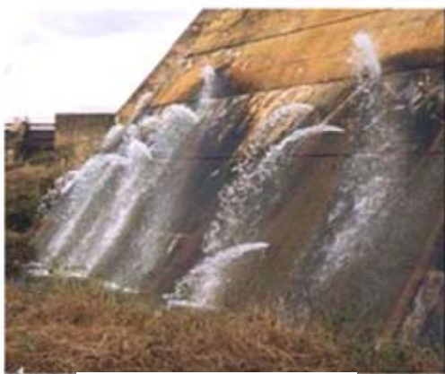
図-1 漏水するダム (*)
