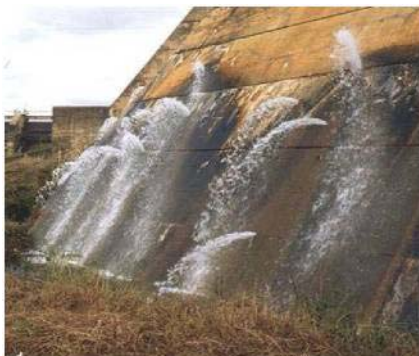
Presas con fugas de água (filtraciones)**
