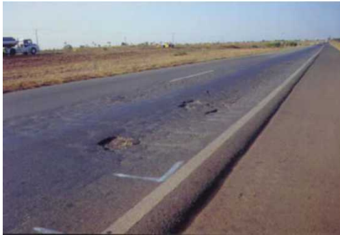
Deteriorari într-un pavaj conventional
