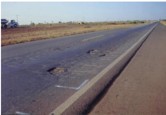
Разрушения в дорожном покрытии
