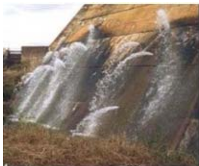
Baraj cu exfiltrații
