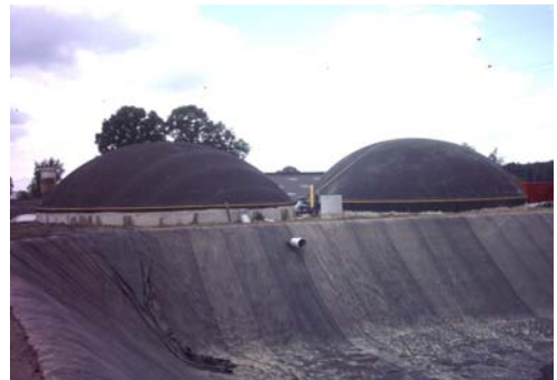
Digesteurs anaérobies avec un bassin de lagunage
